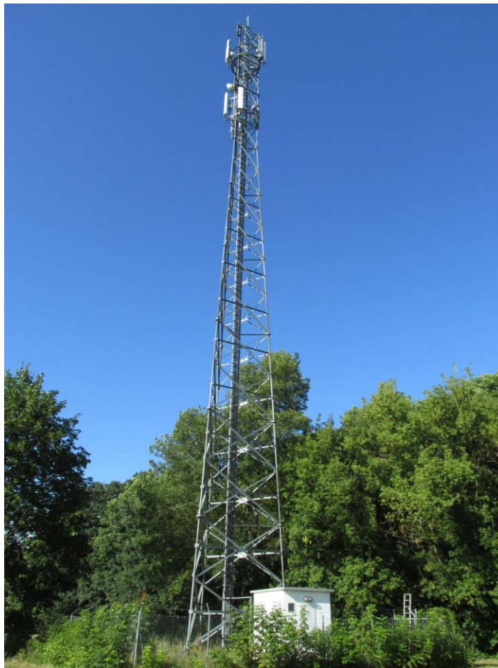
Zał. nr 1: Widok ogólny instalacji radiokomunikacyjnej.
