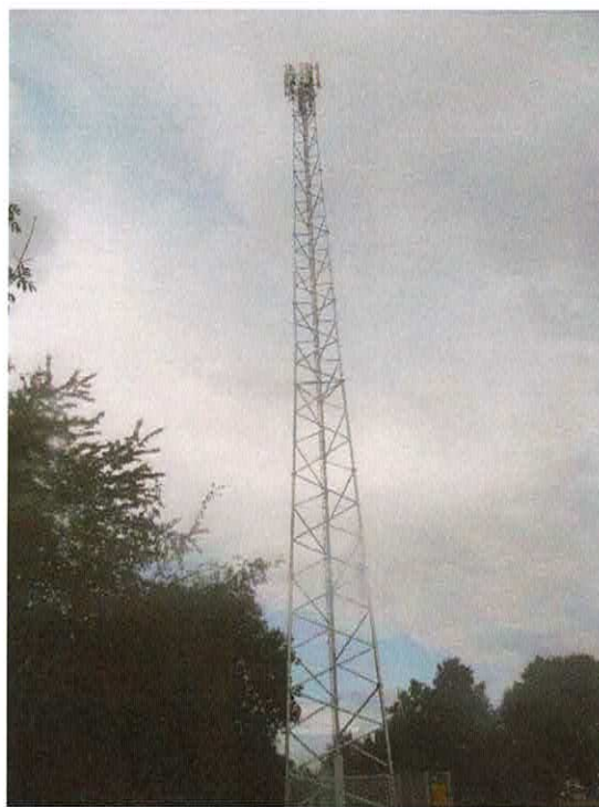
Zat. nr 1: Widok ogólny instalacji radiokomunikacyjnej.
